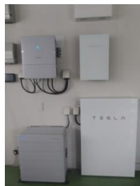
2 台の蓄電池：当社提供写真より
