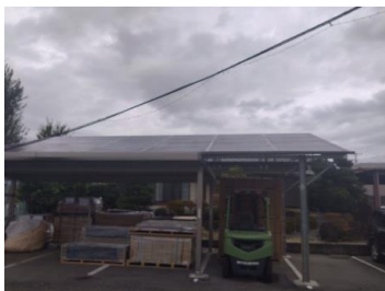
導入しているカーポート型太陽光パネル
