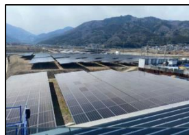
<所有発電所の一例：横からの写真>
